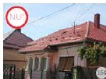
Fig.154. AȘA NU: Folosirea tablei ridice o gamă largă de dificultăți, plecând de la problema redolării ei până la probleme de onestitate: imitarea prin culoare și formă a țiglei ceramice. Cele mai mari probleme rămân însă cele legate de aspect, de încălzire excesivă, care poate crea un disconfort vara într-o mansardă locuită, și de zgornot pe timp de ploale sau grindină. În cele din urmă, tabla este un material ieftin, importat din zona construcțiilor industriale, unde până de curând nu a contat aspectul înșelățului. (Drăguș, jud. Brașov)
