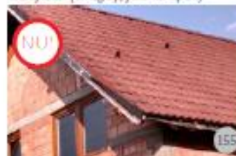
Fig.155. AȘA NU: Folosirea țiglelor „mari” din beton vopălit este total neadecvată. Sunt multe situații în care acestea s-au decolorat, nemălinând cont de aspectul nepotrivit al formei importate.
