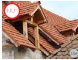
Fig.156. AȘA NU: Folosirea unei țigle care o imită pe cea ceramică (țigle din beton, tablă etc.) are un efect contrastant cu înveltoarea istorică din imagine.
